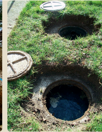
Fosse toutes eaux.
