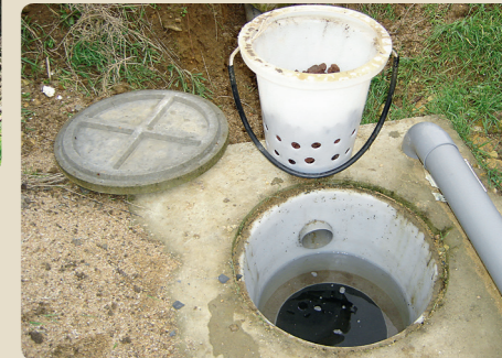
Préfiltre de la fosse toutes eaux.
